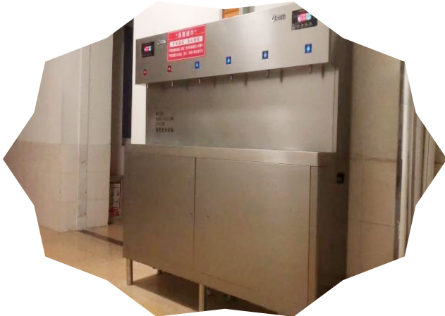
宿舍各楼层安装直饮水机
