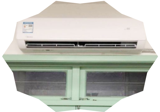
瀚园学生公寓每个房间安装空调
